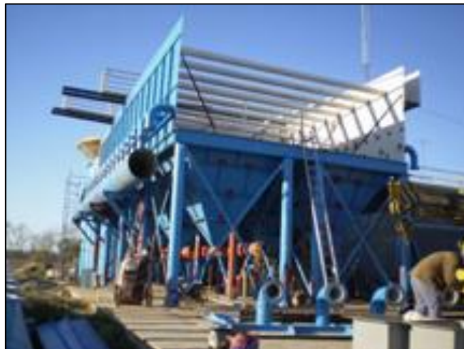
Figura N°7 Decantadores de la planta de abatimiento de arsénico Carlos Casares (Provincia de Buenos Aires) Fuente: Aguas Bonaerenses (26).
