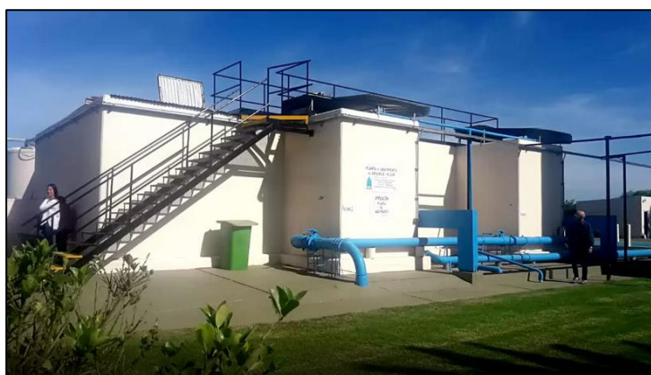
Figura N°12 Planta de abatimiento de arsénico en Villa Cañás, Santa Fe
