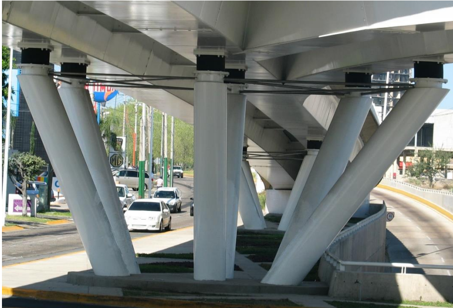
Figura 25: Vista columnas con aislador
