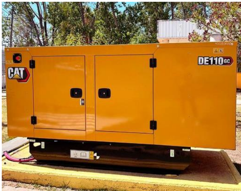
Figura N°9: Grupo electrógeno presente en planta GASTROSUD. Fuente: GASTROSUD S.A, 2022
