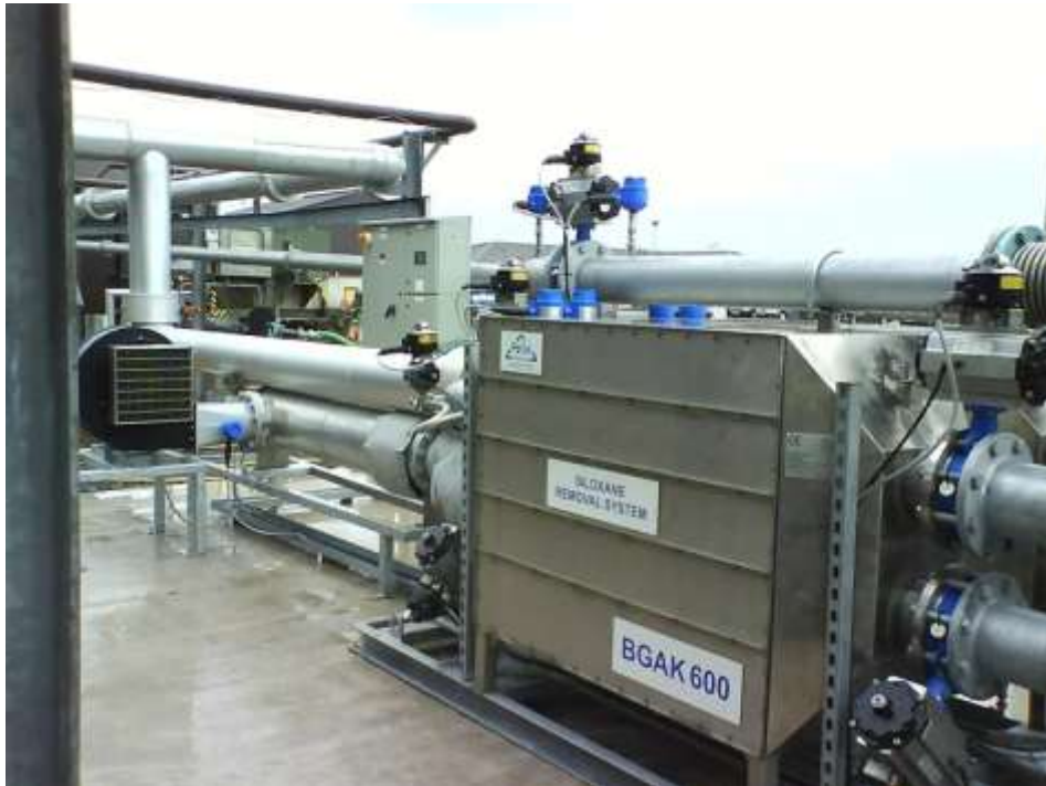
Figura 6.15: Sistema de remoción de siloxanos
