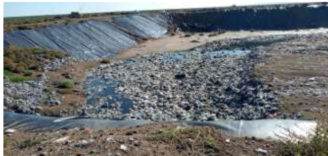
Figura 3.2: Celda sin terminar y con gran cantidad de lixiviados
