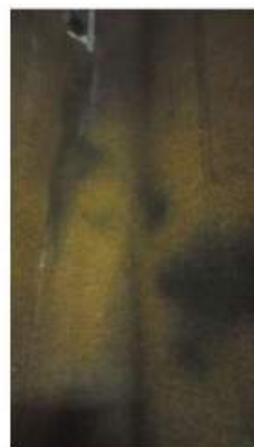
Manchas producidas por hongos
