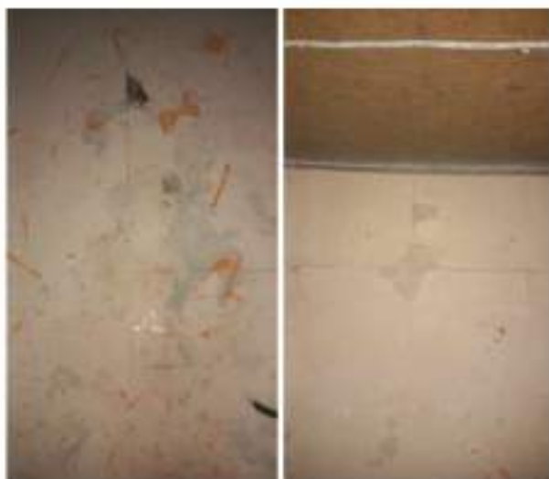
Suciedad y desprendimiento de piso vinílico
