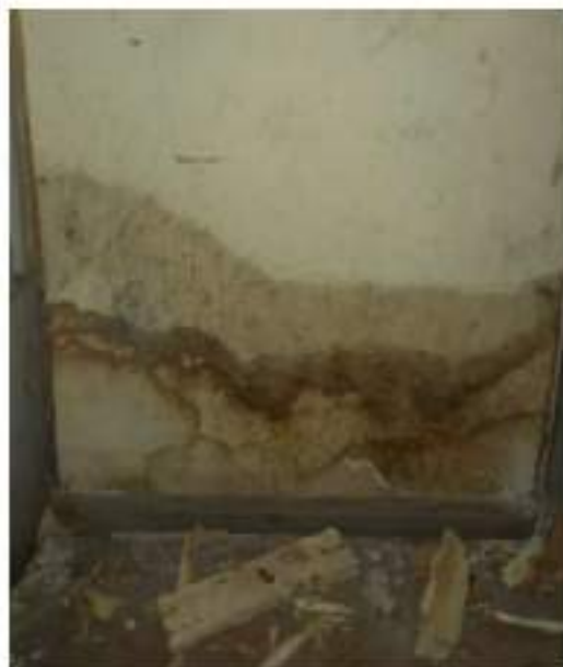
Humedad capilar en muro agregado de OSB
