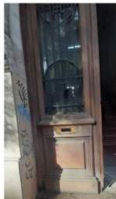
Manija y buzón faltante.
