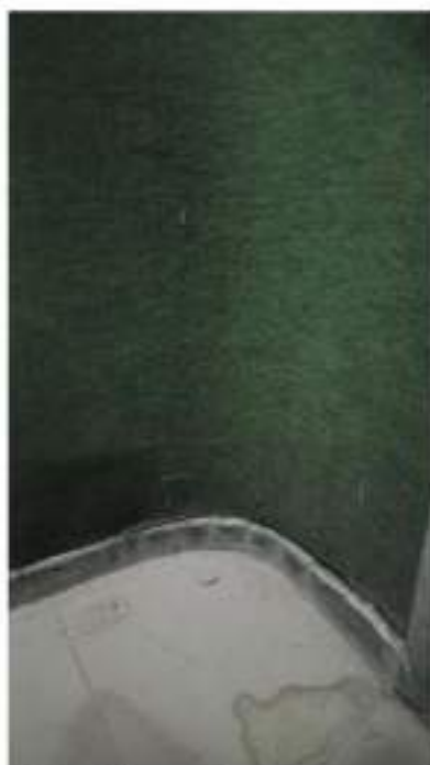
Suciedad y manchas
