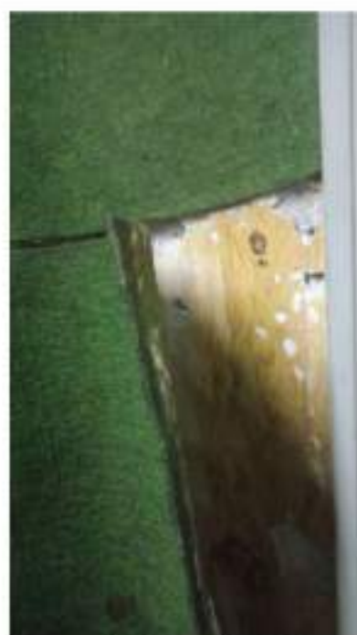
Desprendimiento de la alfombra
