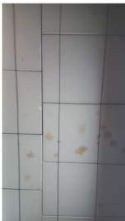
Manchas en el cielorraso
