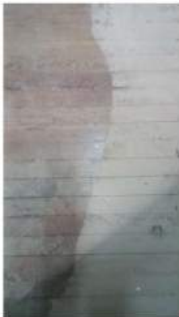
Mancha en el piso de madera
