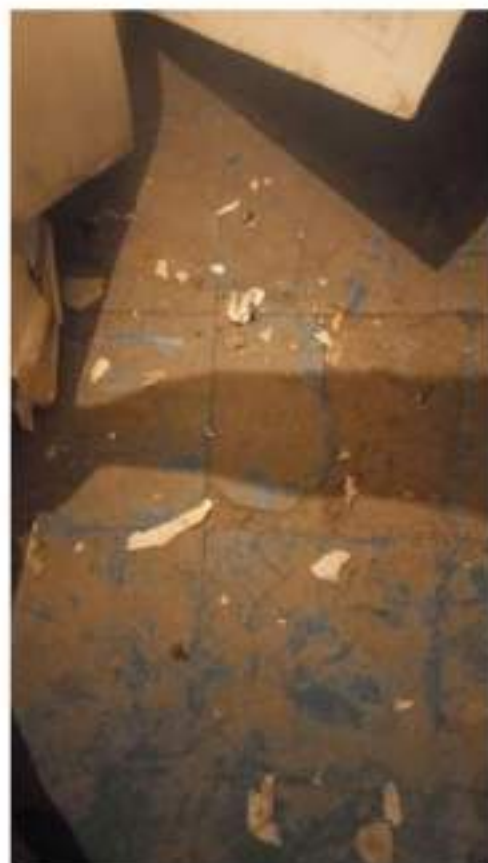
Suciedad y desprendimiento de piso vinílico
