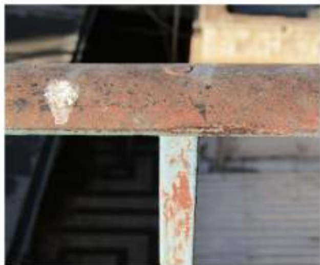
DETALLE OXIDACIÓN DE BARANDA
