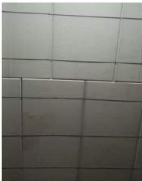
Manchas de humedad por filtración en el cielorraso
