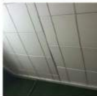
Desprendimiento del cielorraso
