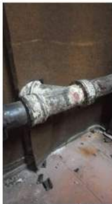
Erosión química en cañería y desprendimiento de zócalos.
