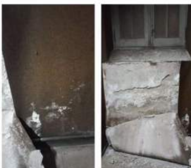
Revoque disgregado y eflorescencia en el alfombrado. Desprendimiento de la alfombra.
