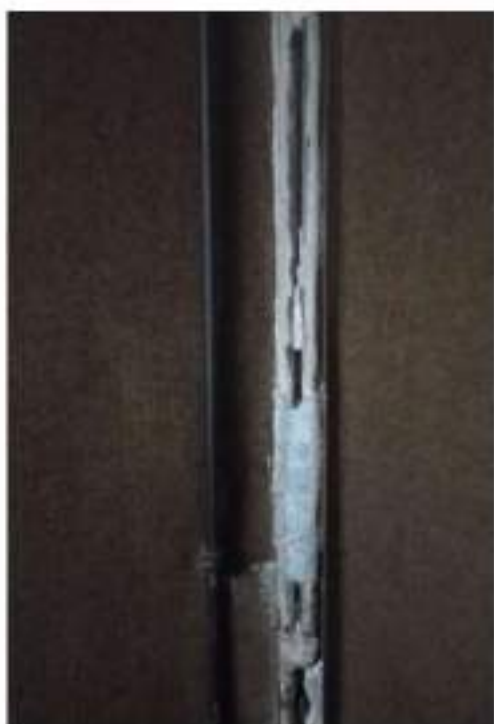
Oxidación de cañerías
