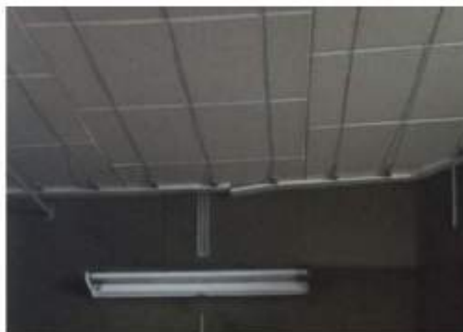
Desprendimiento del cielorraso
