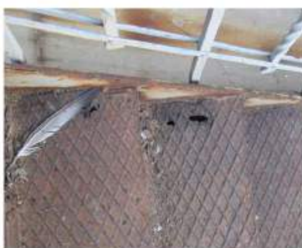
DETALLE CORROSIÓN Y SUCIEDAD 2DO TRAMO
