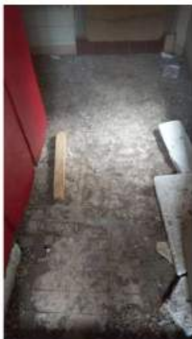
Suciedad acumulada en el ingreso
