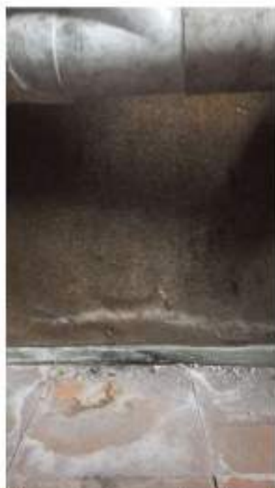
Eflorescencias y manchas de óxido en el encuentro muro-piso
