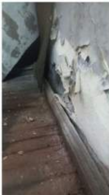
Exfoliación de Pintura (Craquelado). Desprendimiento de la alfombra
