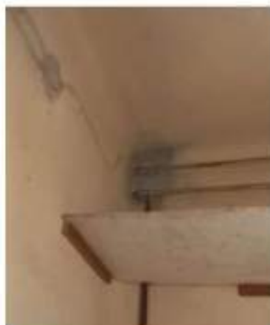
Fisura horizontal y reparaciones cementicias por instalación de cañerías
