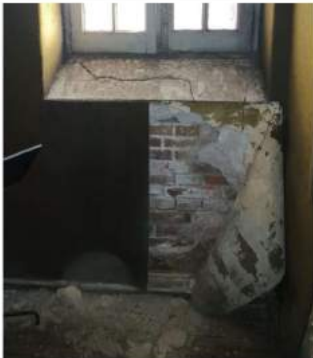
Revoque disgregado y desprendimiento de alfombra
