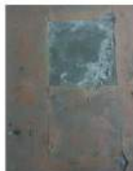
Desprendimientos y fisuras en baldosas
