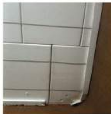
Desprendimientos en el cielorraso.
