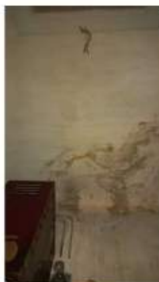
Humedad por filtración
