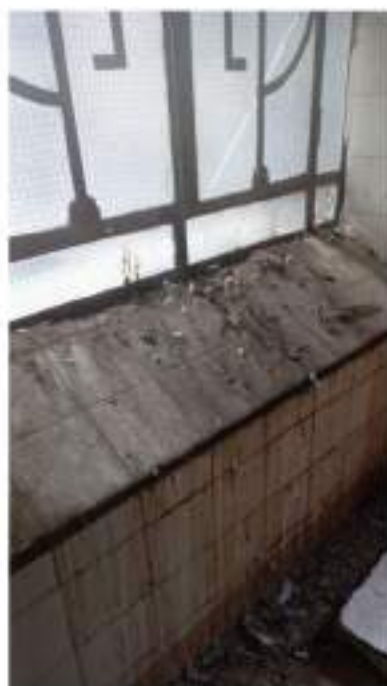
Antepecho sucio y vidrio roto.
